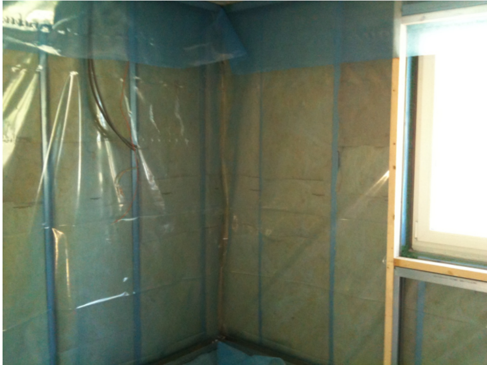
Figur 4. Diffusionsspärr och lufttätande skikt av plastfilm som lätt kan skadas vid montering. Foto: Per Wickman, Aton.
